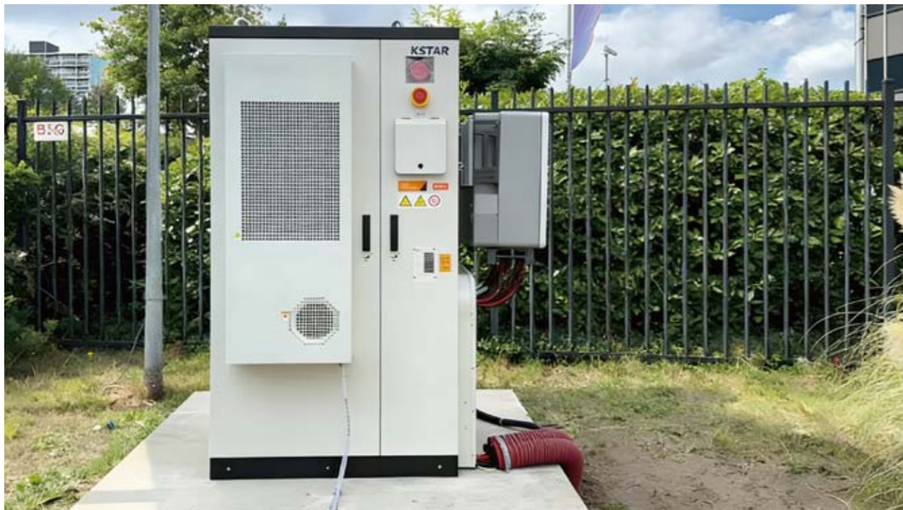
04 C&I ESS Projekt in den Niederlanden
