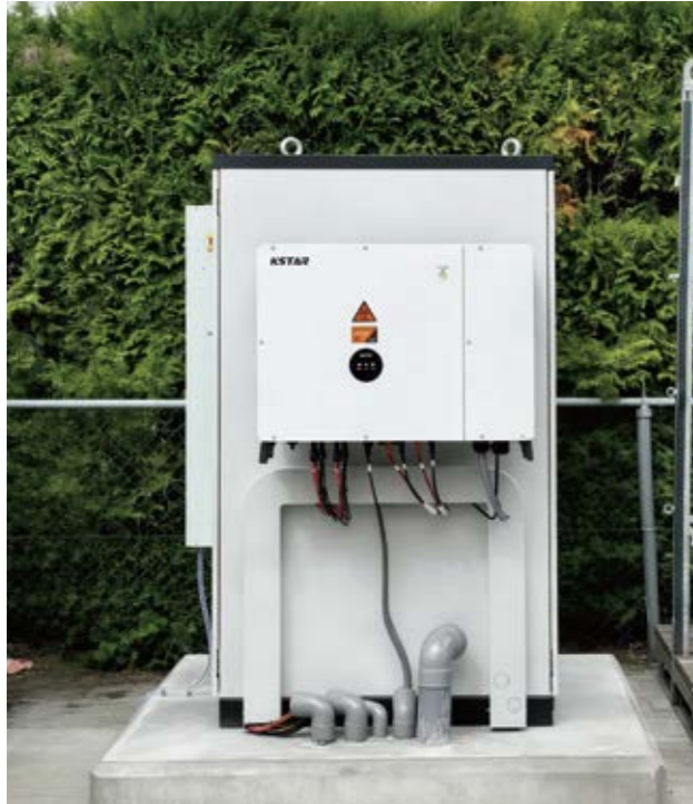
01 C&I ESS Projekt in den Niederlanden
